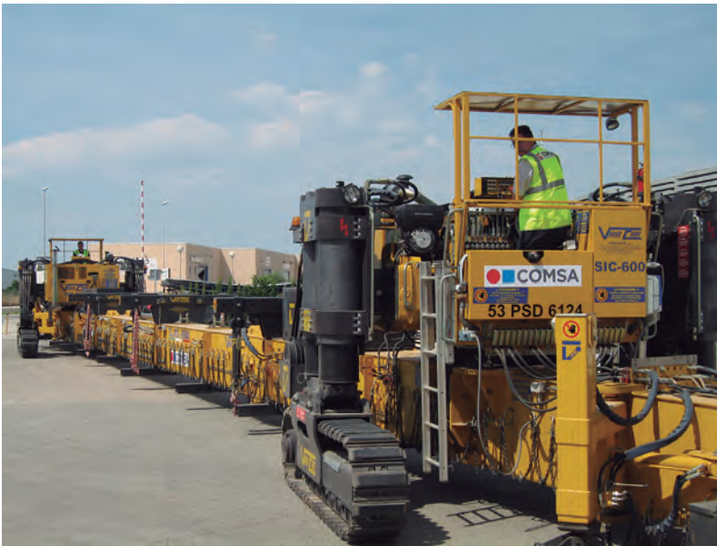
Imagen 2.25. Pórtico de cambio de desvíos. Fuente: COMSA
