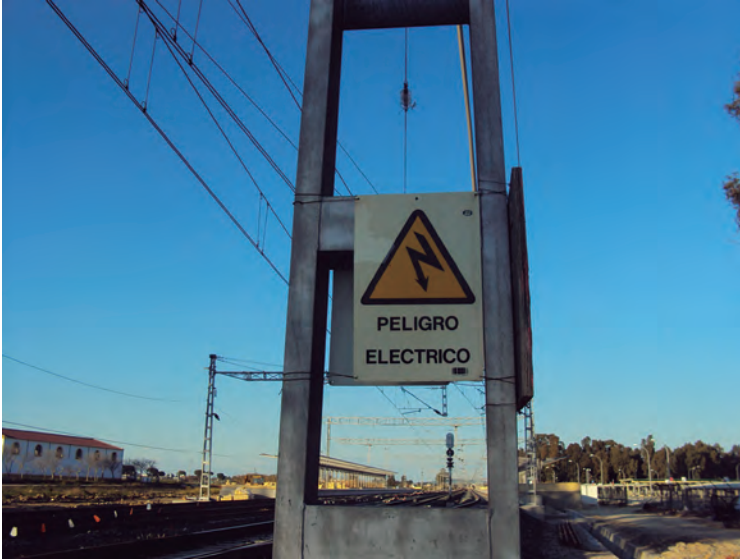
Imagen 6.10. Señalización de riesgo eléctrico. Fuente: COMSA
