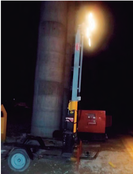
Imagen 3.29. Torre de iluminación. Fuente: VIAS
