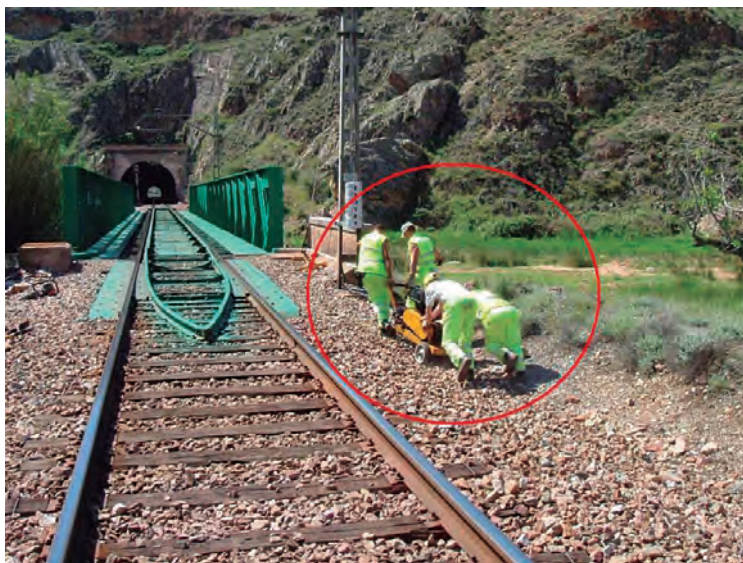
Imagen 5.7. Riesgo de arrollamiento. Fuente: COMSA
