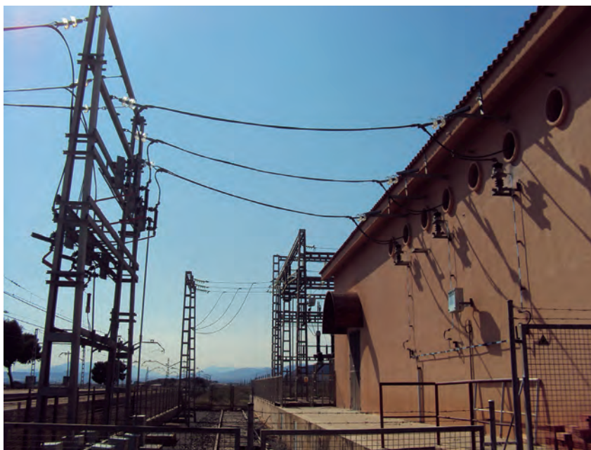
Imagen 6.1. Subestación eléctrica. Fuente: VIAS
