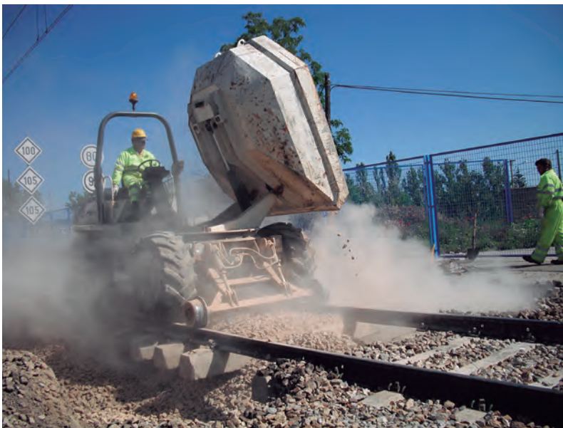
Imagen 3.27. Polvo por vertido de balasto. Fuente: TECSA
