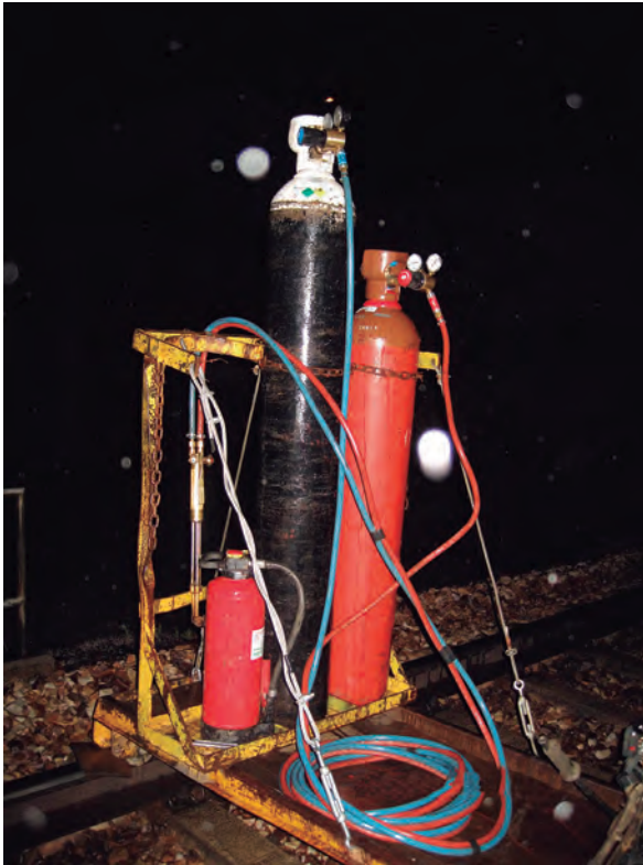
Imagen 3.21. Botellas de acetileno para soldadura. Fuente: COMSA
