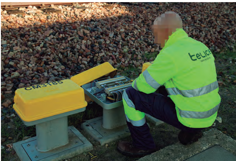
Imagen 6.3. Instalaciones a pie de vía. Fuente: TELICE
