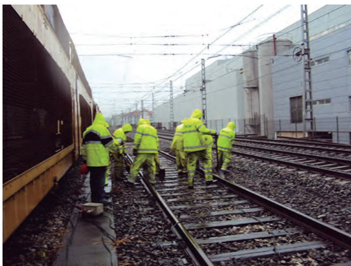
Imagen 3.14. Trabajos con riesgo de arrollamiento. Fuente: TECSA
