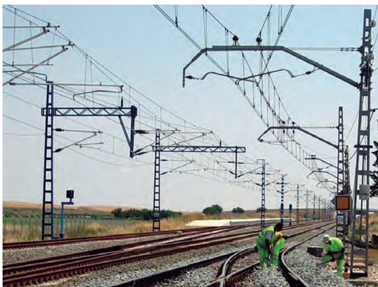
Imagen 6.6. Línea aérea de contacto. Fuente: COMSA
