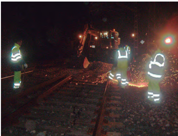
Imagen 3.4. Trabajos con deficiente nivel de iluminación. Fuente: COMSA
